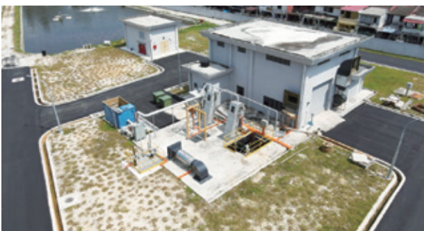
Pakej D43 – Cadangan Pembinaan Rangkaian Paip Pembentukan dan Rasionalisasi Loji Rawatan Kumbahan Kawasan Tadahan Batu, Jinjang Kepong, Kuala Lumpur
